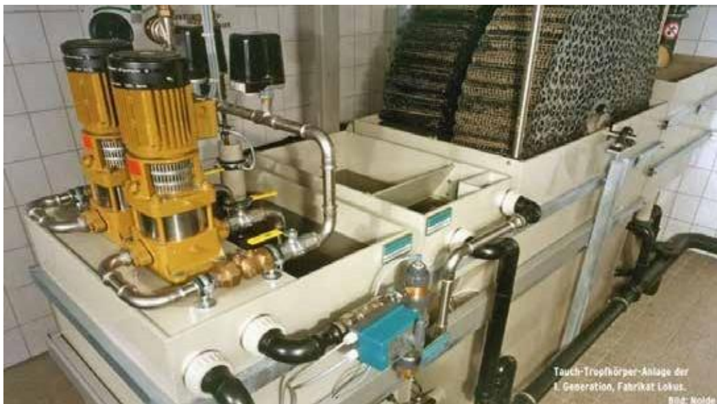
11. ábra: Forgó biológiai kontaktorok (RBC) egy többszintes épületben. Első generációs rendszer a szürkevíz újrahasznosítására 1995-ből (Fotó: E. Nolde).
