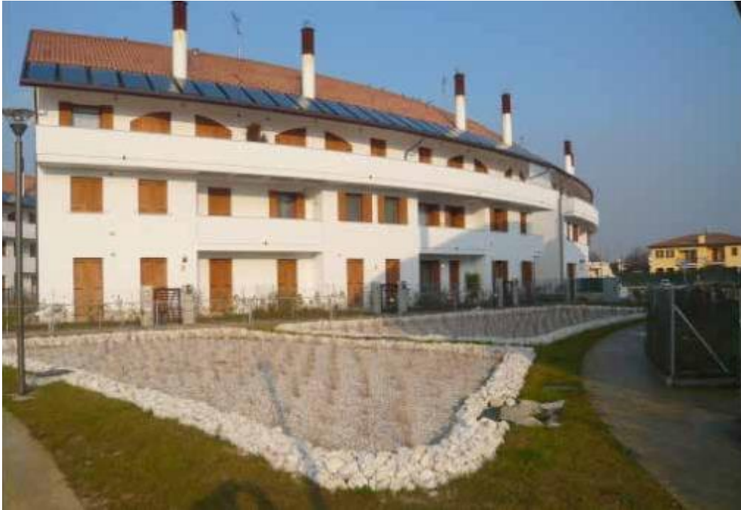
17. ábra: HF rendszer a szürkevíz szétválasztására, kezelésére és újrafelhasználására WC-öblítéshez Preganziol (TV - Olaszország) 45 .
