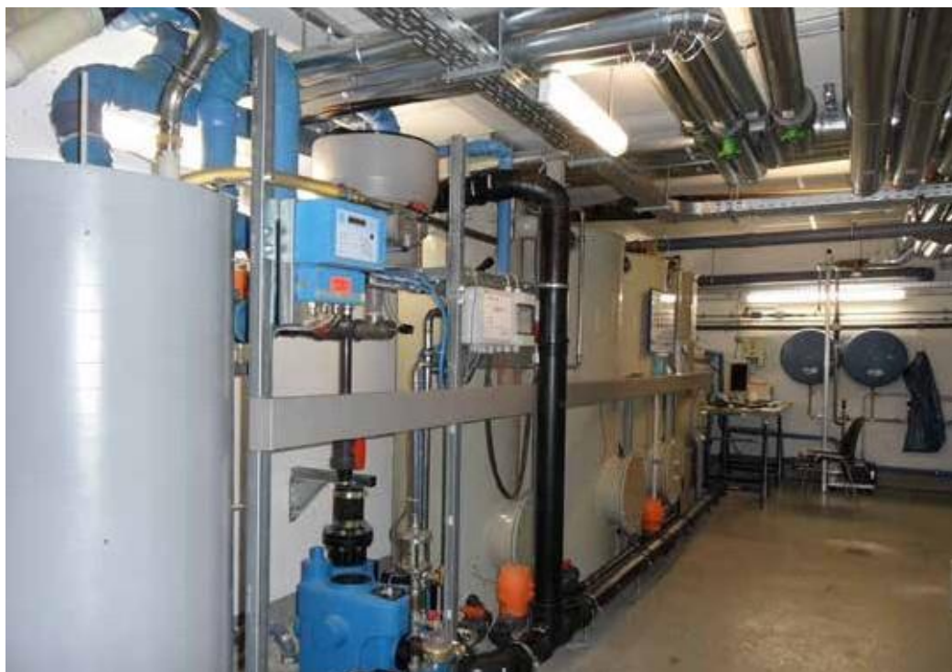
24. ábra: Szürkevíz újrahasznosító rendszer, beleértve a szürkevízből történő hővisszanyerést az épület pincéjében.
